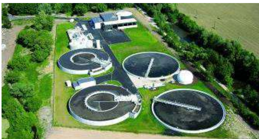
Vue aérienne de la station d'épuration de Haguenau
