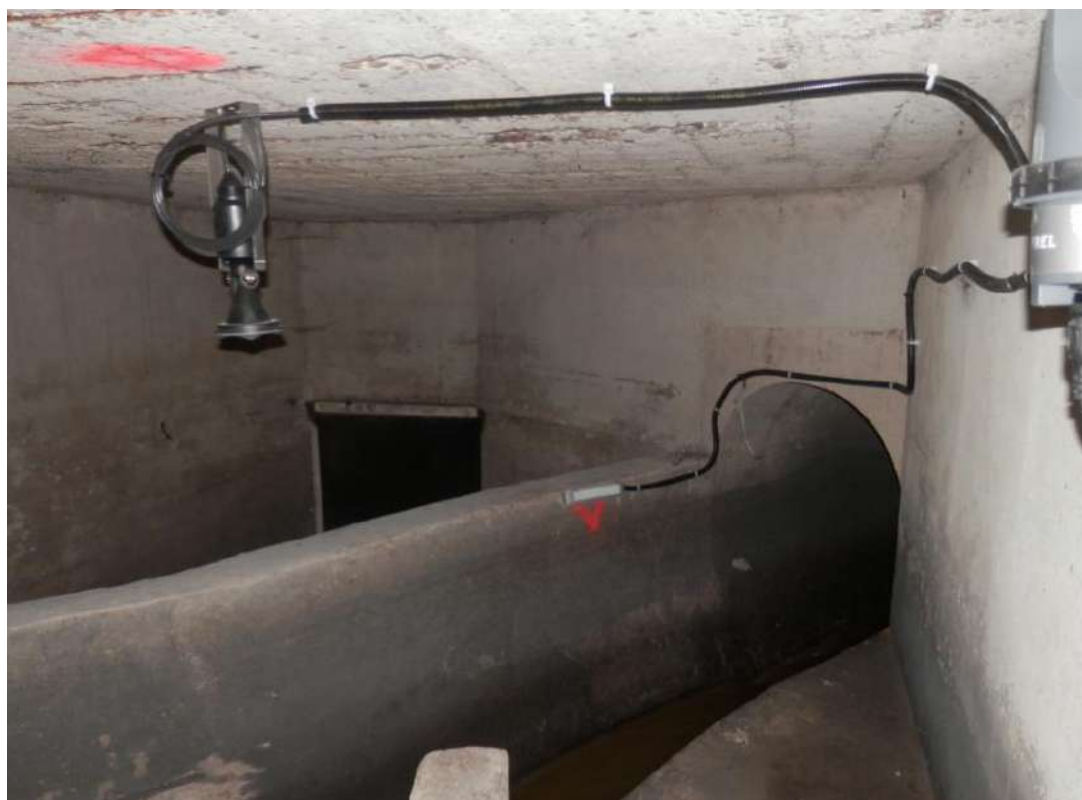
Exemple d'équipement d'autosurveillance au niveau d'un déversoir d'orage
